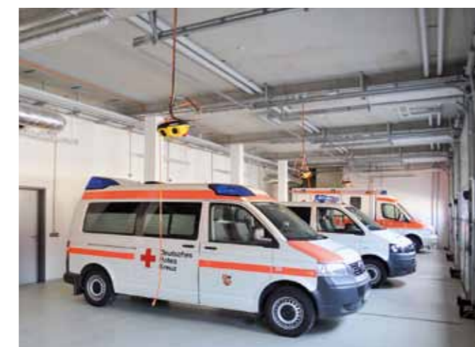
Strom von der Decke und viel Platz: Die Fahrzeughalle ist nicht mit den beengten Garagen des alten Gebäudes vergleichbar.
